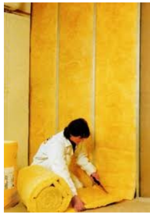
Lana de vidrio en paredes
